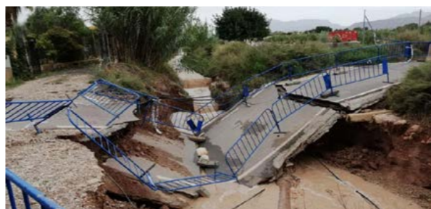
>> Carreteras reventadas por la lluvia.
