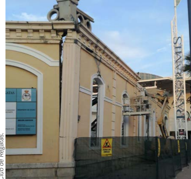
Se derrumba el techo de la portada del Club de Regatas.
